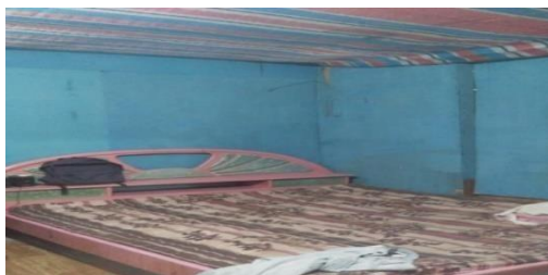
Gambar 3. Kondisi kamar yang Lembab tanpa jendela
